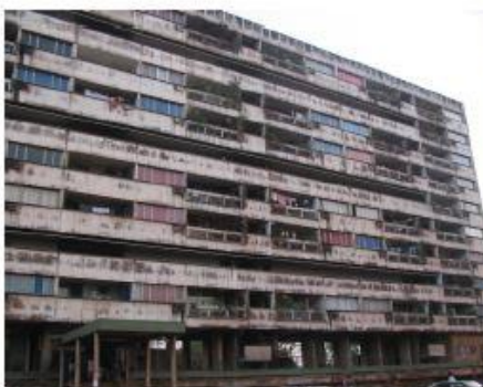
Immeubles très dégradés (2004)
